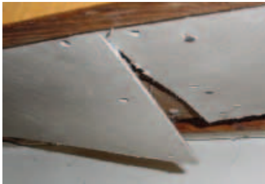
Panneaux légers contenant de l'amiante
